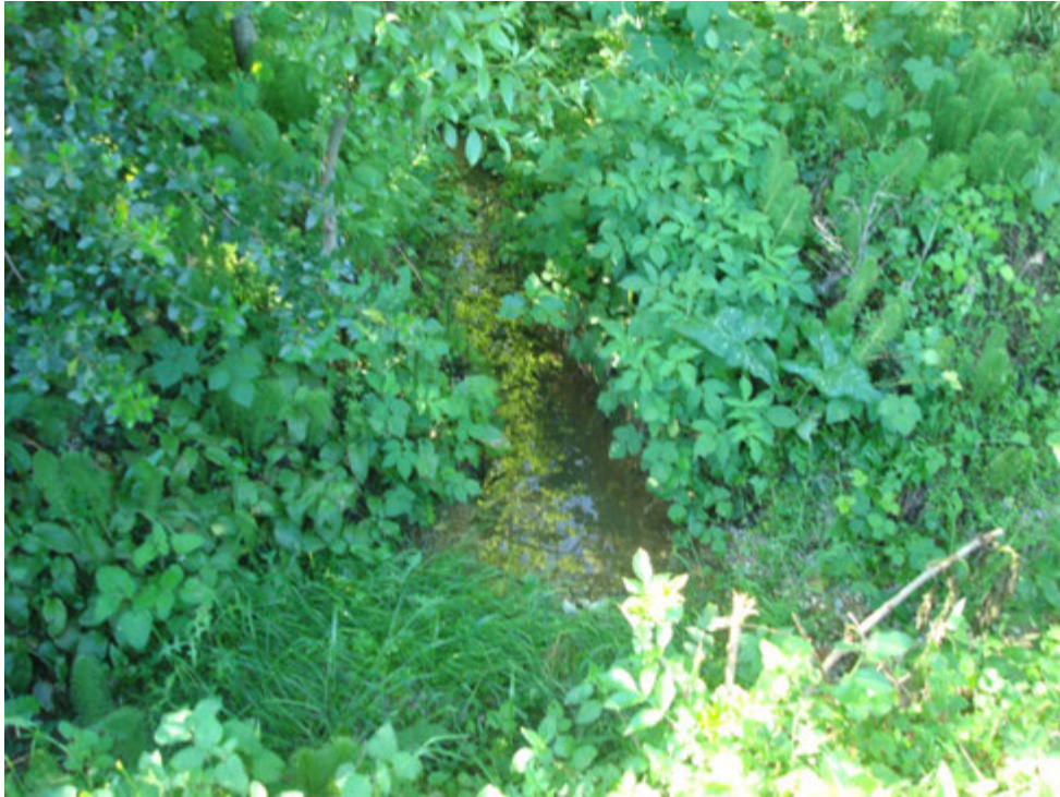
Foto 4- Ristagni idrici a ridosso della stessa sede stradale
